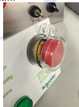
Bloqueio de botoeira de emergência
